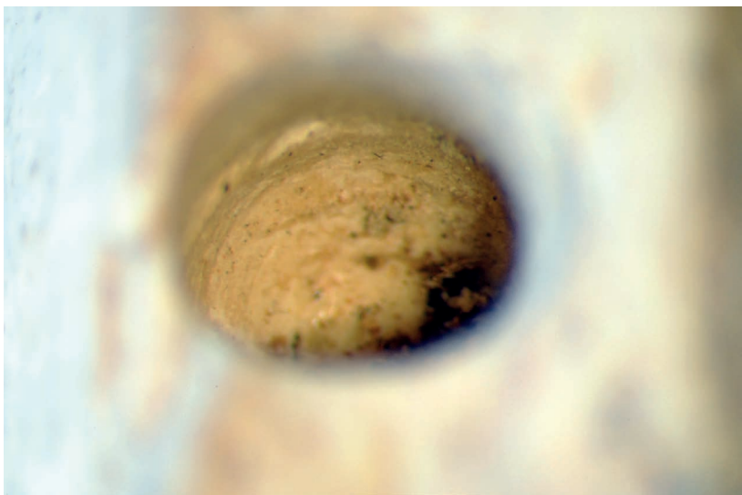
Abb. 5: Bohrloch ohne Korrosionsrückstände (Foto Gert Jendritzki)
