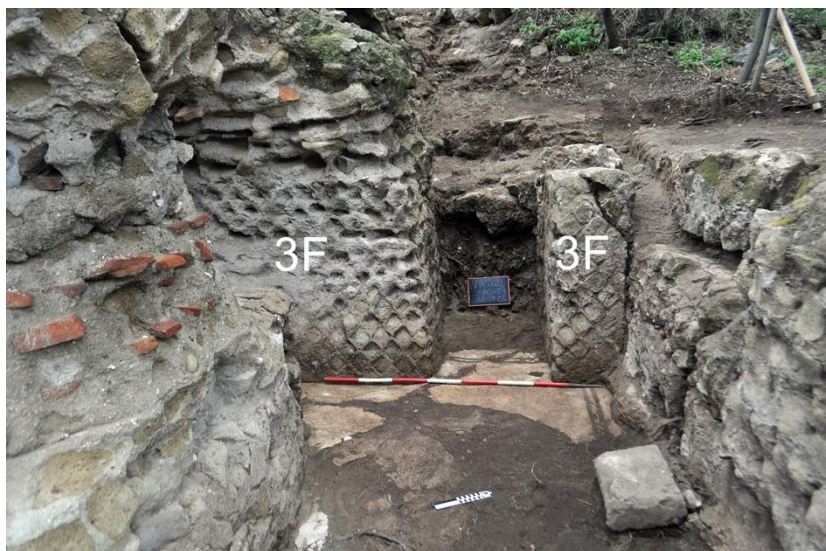
Fig. 11 - Paramento interno, in opera reticolata, del muro di delimitazione Ovest dell'attuale ambiente, da Est
