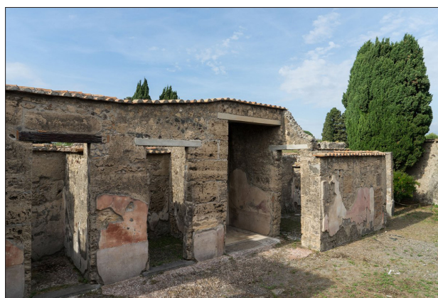
Fig. 1. Pompei, Casa del Chirurgo (VI, 1, 10.23), atrio, muri in opera quadrata di travertino.
