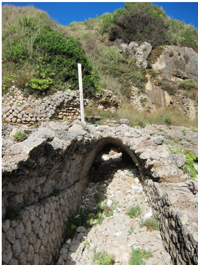
Fig. 25 - Canalizzazioni nella terrazza inferiore della villa
