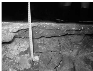
Fig. 16: La sezione del camminamento in malta cementuata in epoca risalente.
