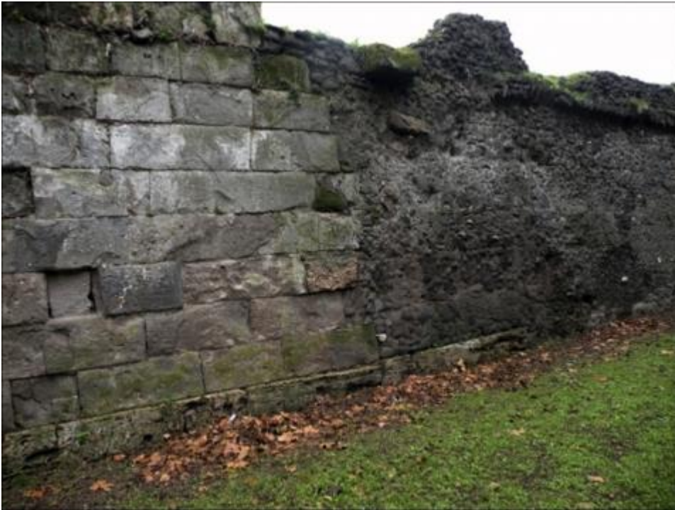
Fig. 1 - Pompei. Tratto fra Porta Ercolano e la Torre XII, rifacimento in opera incerta.
